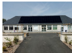
Scrignac | Installation PV d'autoconsommation collective sur la salle polyvalente
